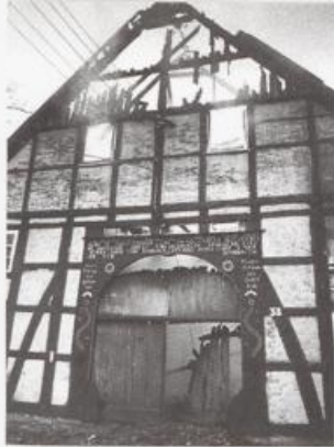
Abb. 13.12 Gehring's Wohnhaus nach dem Brand, Rückansicht, 1984. (Foto: Rudolf Gehring)
